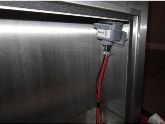
Power Cable in Kiosk
